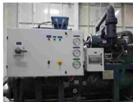
Εικόνα 1: Οι μονάδες chiller στη τελική τους θέση έτοιμες για λειτουργία.
