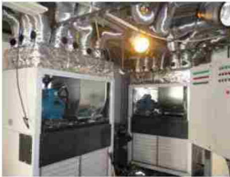
Εικόνα 2: Όψη των 2 από τις 15 νέες κλιματιστικές μονάδες και του πίνακα αυτοματισμού τους
